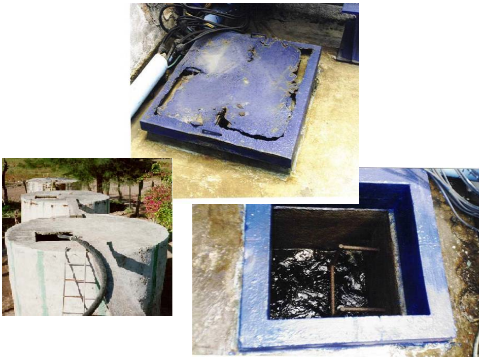
Fotografía No.6: Tanques propensos a contaminación
