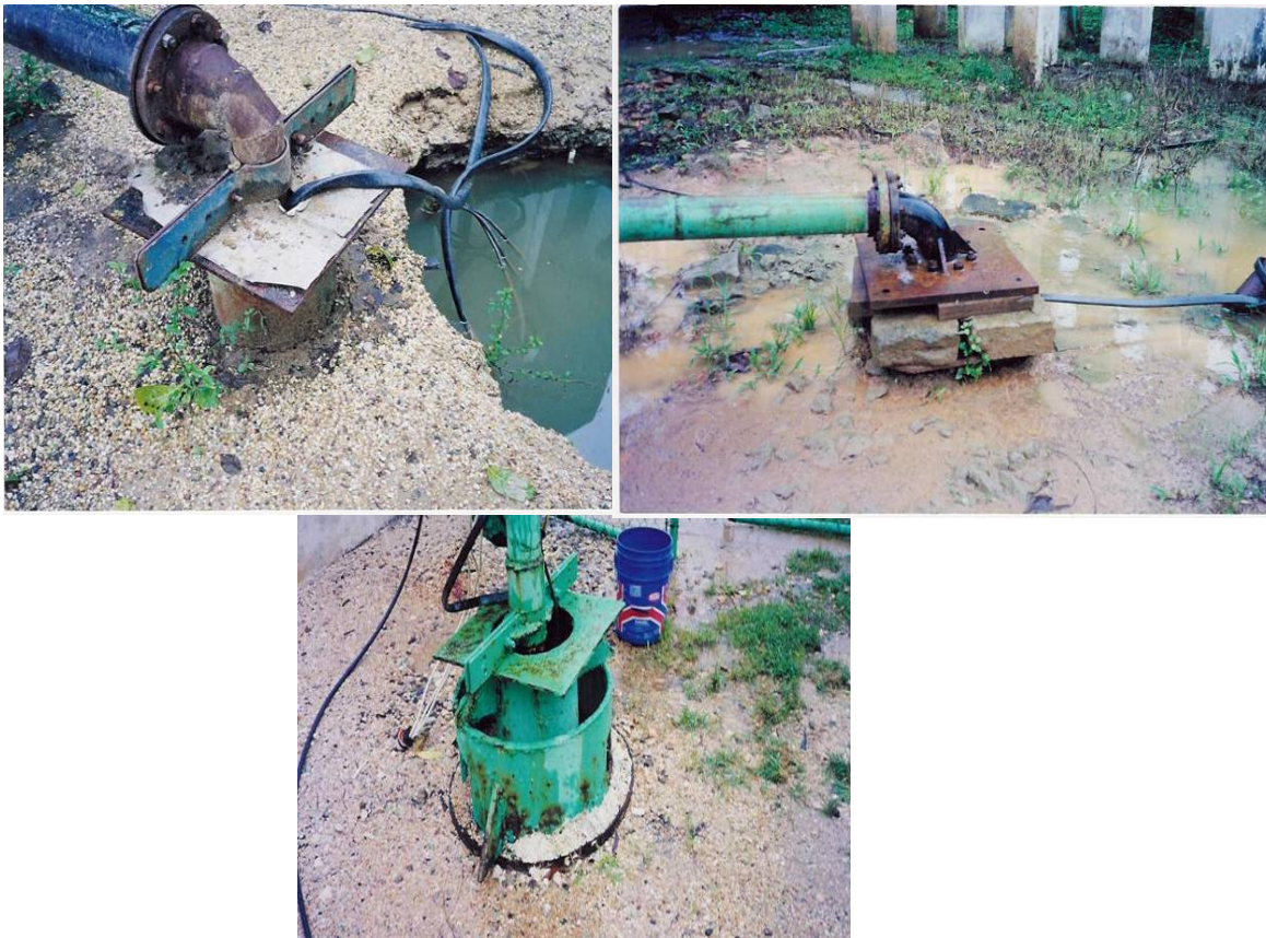
Fotografía No.3: Peligros en Pozos
