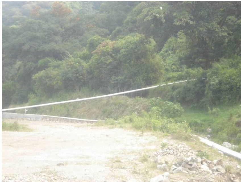
Fotografía No.4: Pasos aereos sin anclajes en una línea de conducción
