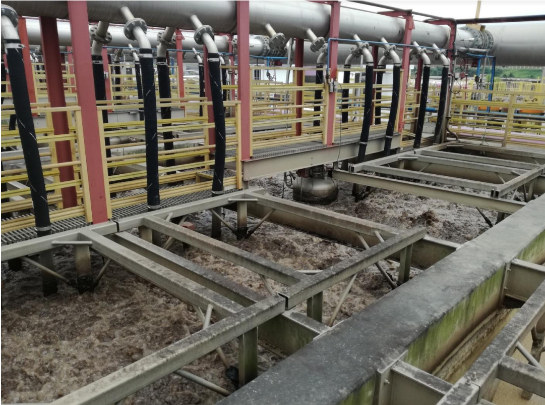
Figura 8. Reactor tipo MBR de la estación de reutilización ABC/Aquapolo.
