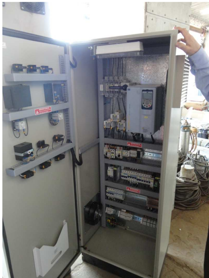
Manutenção do quadro de eletricidade de um dos poços de abastecimento
