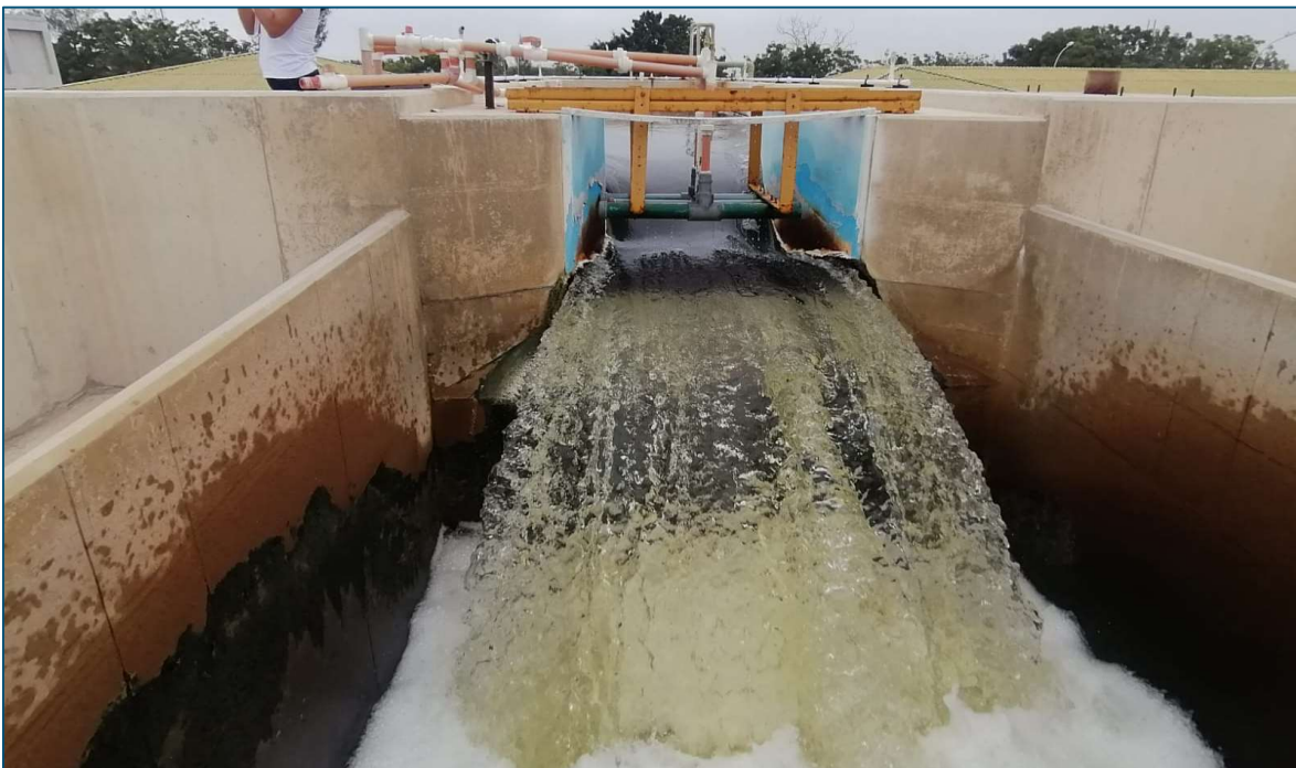
Canal Parshall de ingreso al sistema de tratamiento, pre-cloración.
