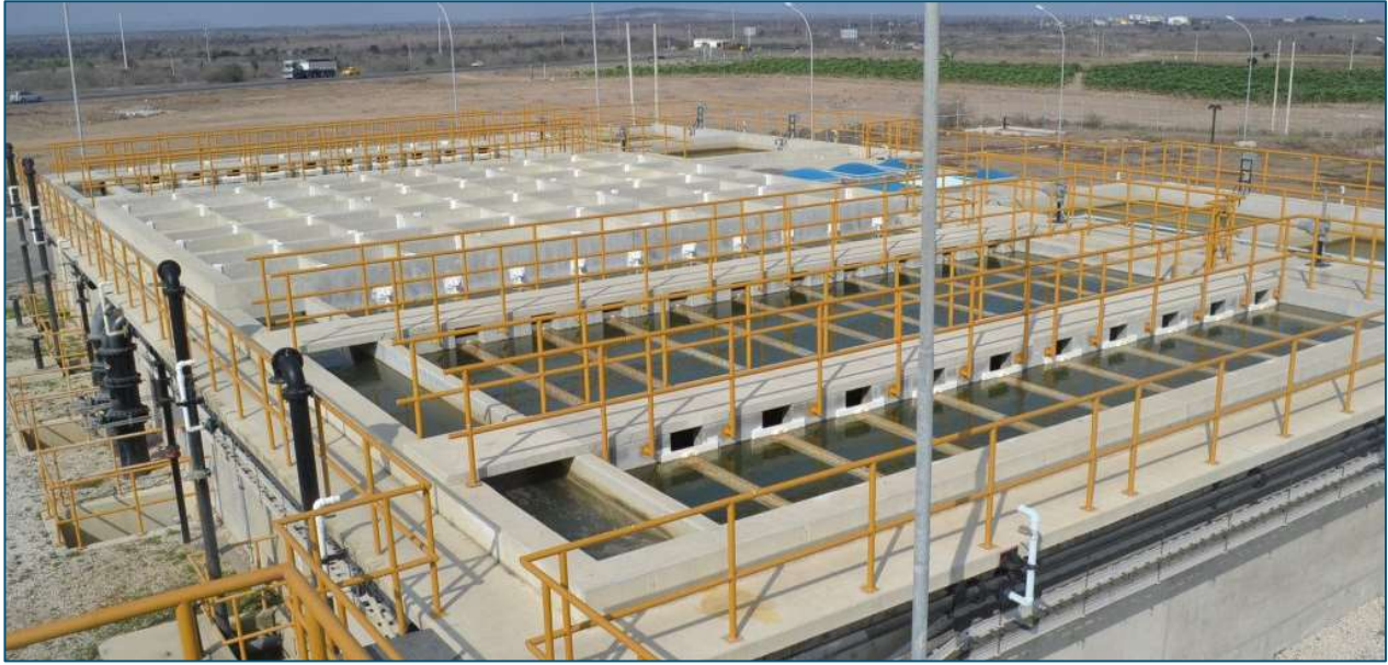
Vista de los módulos de tratamiento
