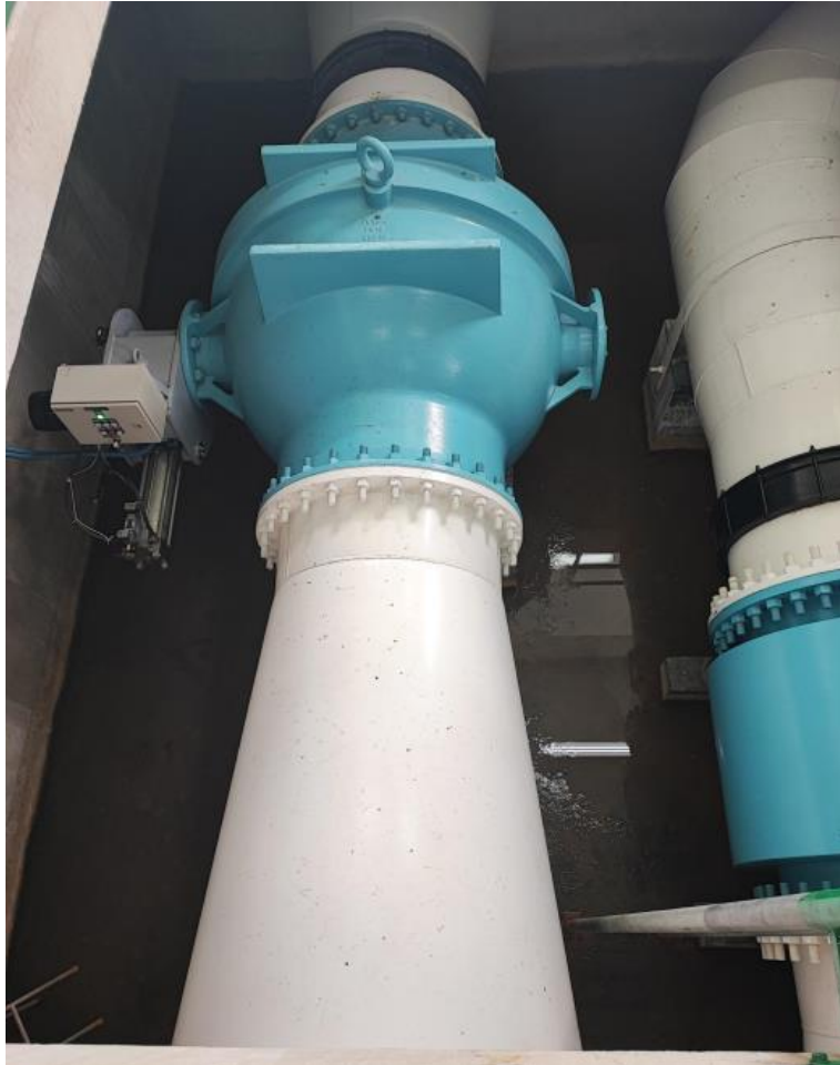
Fig. 16. A la derecha se muestra la línea de aducción hacia la central eléctrica con un medidor tipo electromagnético en un diámetro de 900 mm; al lado izquierdo se muestra la tubería de desfogue de la laguna La Mica, para garantizar siempre un volumen útil para generación y abastecimiento.
