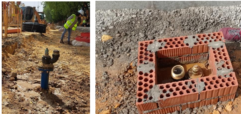
Foto 12. Bocas de riego
