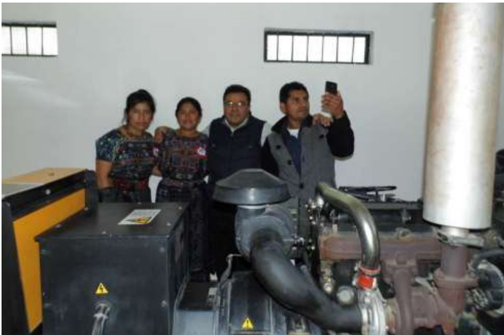
Política de aseguramiento del servicio, instalación de generador eléctrico.
